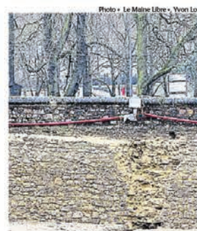
La muraille médiévale, décaissée d'une hauteur de deux mètres, sera visible du public.
